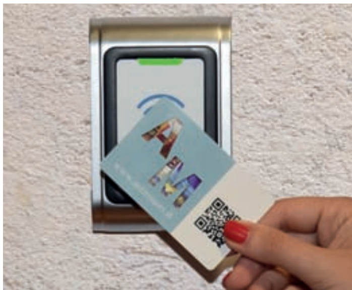
Il riconoscimento e l'ingresso dei visitatori ai siti è gestito da un'unità elettronica di controllo accessi di ultima generazione. I lettori sono anti-vandalo e waterproof. (Courtesy: Elex srl).
